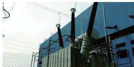
Индия: трансформатор 420kV 60MVA
