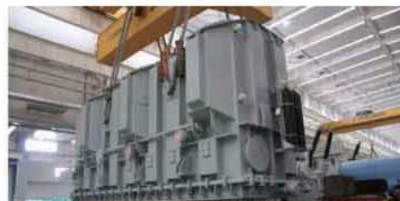
Пуэрто-Рико: трансформатор USA230kV 570MVA
