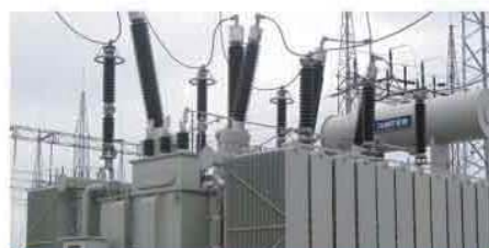
Эквадор: силовой трансформатор для CELEC S.A
