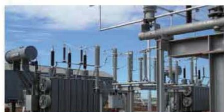
Австралия: трансформатор 132kV для ВНП
