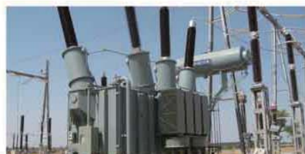
Буркина-Фасо: силовой трансформатор для Forclum
