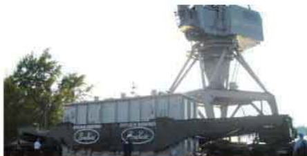
Сербия: трансформатор 400kV 400MVA
