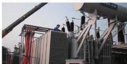
Бангладеш: силовой трансформатор для Aggreko
