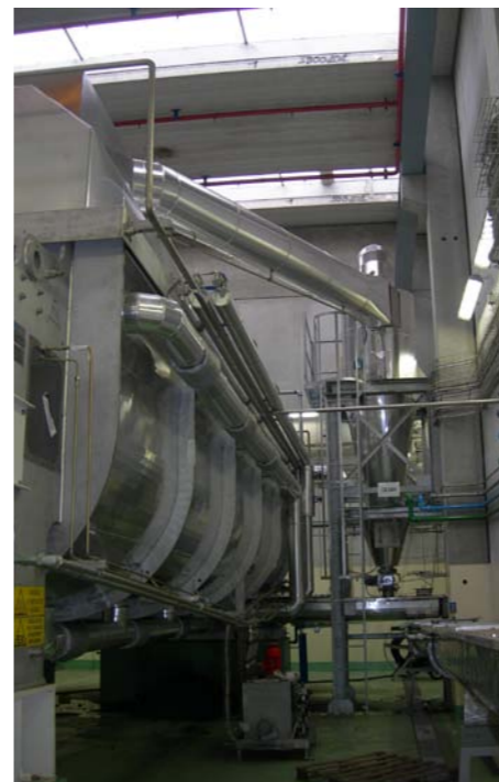
▲ Очистные сооружения Torino, Италия
