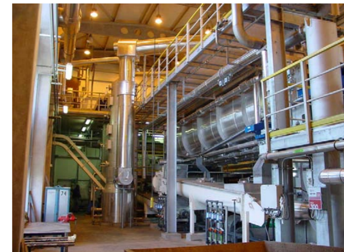
▲ Очистные сооружения Modrice, Чехия
