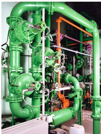
Водоподготовка на электростанции
