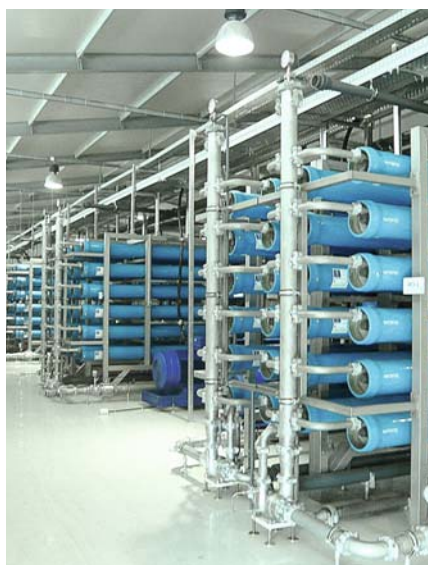
Установка обратного осмоса. Источник: Watertec T.A. GmbH
