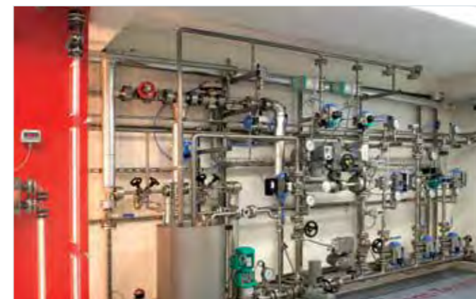
Комплектное промышленное оборудование
